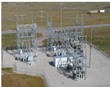
Ci-dessus: Le poste électrique existant High River 655
